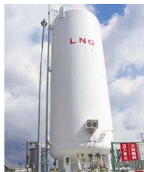
辰野事業場のLNG化を実現した新ボイラー
